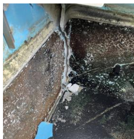
浄水場沈澱池の躯体ひび割れ
