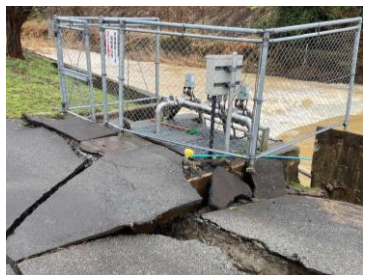
浄水場取水口の損傷
