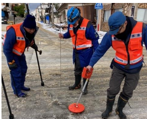
漏水調査 (令和6年能登半島地震)
